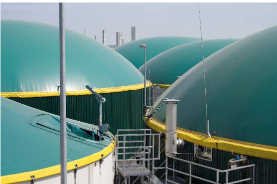
Installation de biogaz à Willingshausen, avec un rendement de 800 Nm 3 /h et une production annuelle de 9,1 millions Nm 3 de biogaz et 3,5 millions Nm 3 de biométhane.
