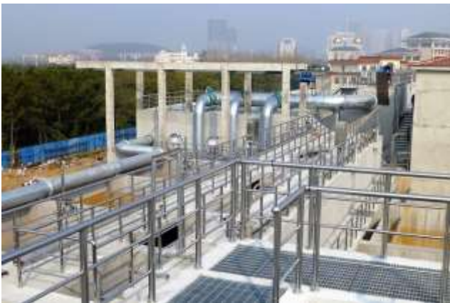
中国当地一家污水处理厂的生物滤池
