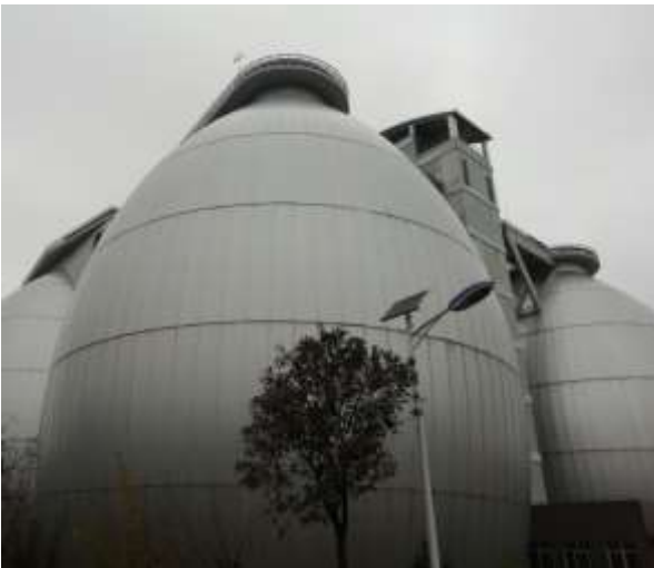
一家中国城镇污水处理厂的蛋形污泥厌氧消化池塔
