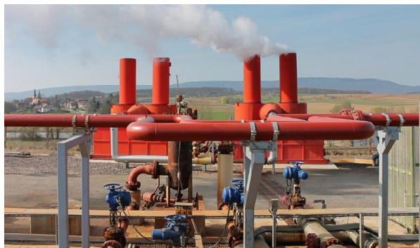
Geothermiekraftwerk in Soult.
