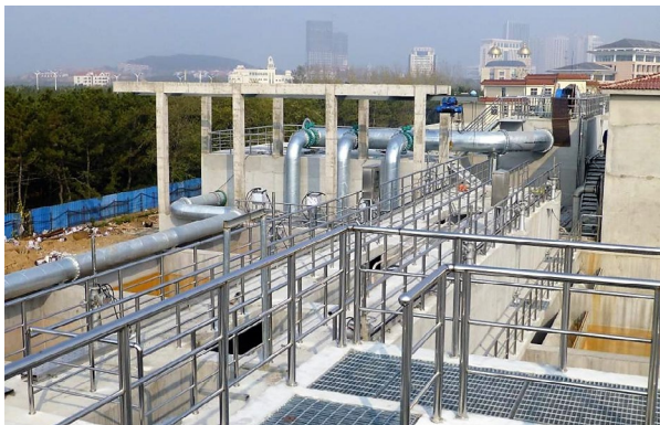
Biofiltrationsanlage einer chinesischen kommunalen Kläranlage.
