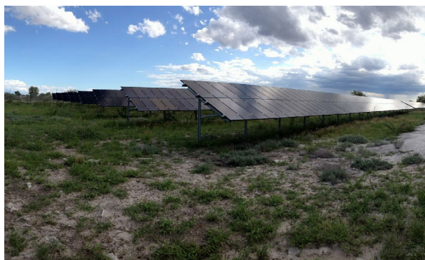
Die Photovoltaik-Anlage in Gam in der Region Otjozondjupa im Nordosten von Namibia ist das derzeit größte netzferne Hybrid-Energiesystem des Landes.
