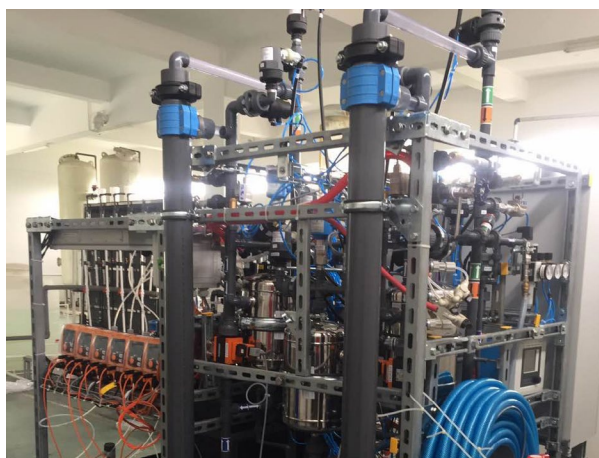
Pilot-Membrananlage in China.
